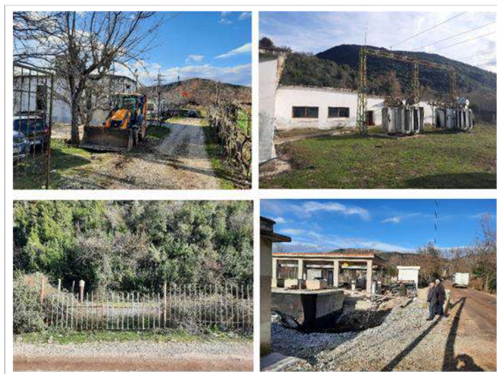
Fig. 155: Stacioni ekzistues i Pompimit të Poçemit, si dhe Stacioni i ri i Pompimit në burimet e Poçemit.
